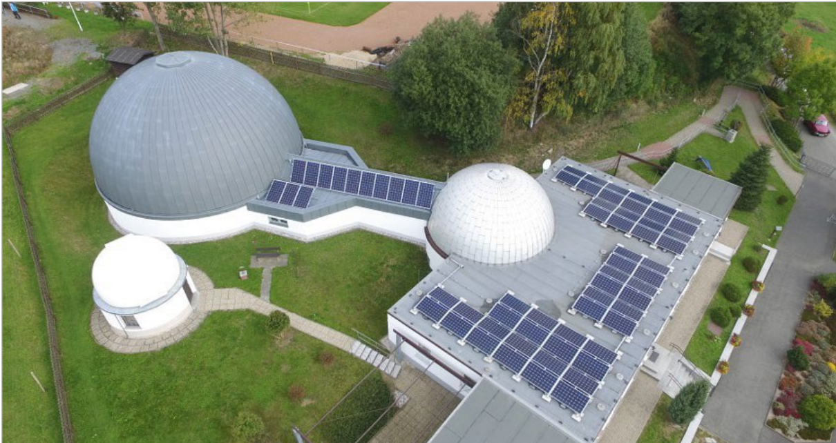
Abbildung 29: Photovoltaikanlage Drebacher Planetarium (Bürger Energie Drebach eG, o. J.).
